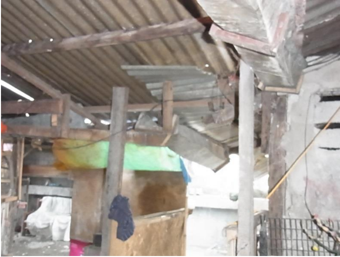
台風の被害後もそのまま
